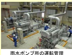
雨水ポンプ所の運転管理
